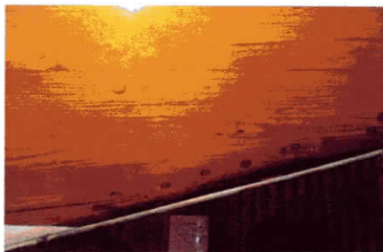
Här syns tydligt hur rostade järnbultar angripit träet runtomkring och mörkfärgat det.
